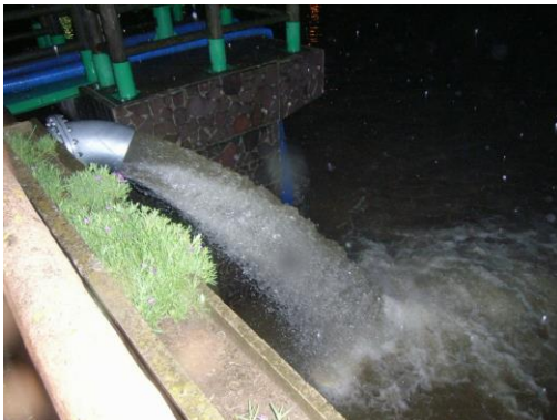
大曲地域 北都銀行裏 排水状況
